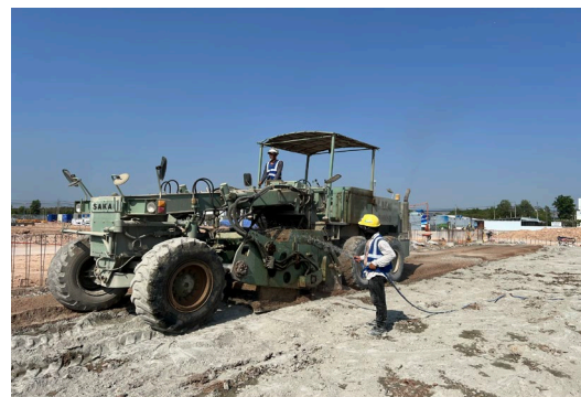
スタビライザーによるセメント改良工事 日系ゼネコンを始め、ローカルゼネコンからも受注しています。 【南部メコンデルタ地区】
